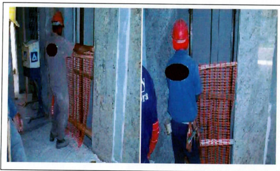
Figura 36: Colaboradores da obra instalando as proteções após acidente
