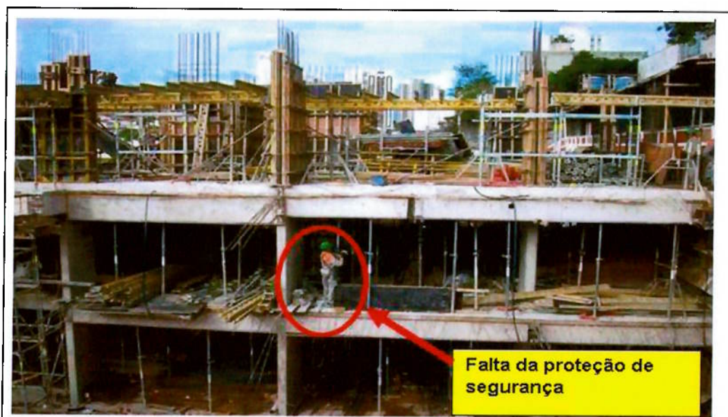
Figura 2 adaptado: Risco de quedas dos trabalhadores por falta de medidas de proteção foi um dos principais problemas encontrados nos canteiros
