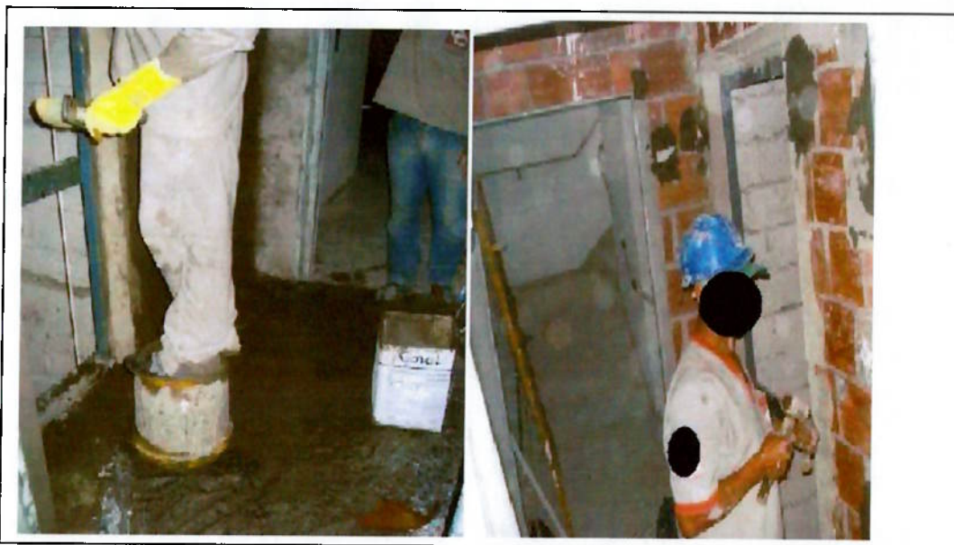
Figuras 39 – riscos de queda dos colaboradores da obra
