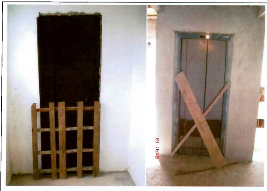
Figura 37: proteções inadequadas instaladas nas portas de pavimentos dos elevadores
