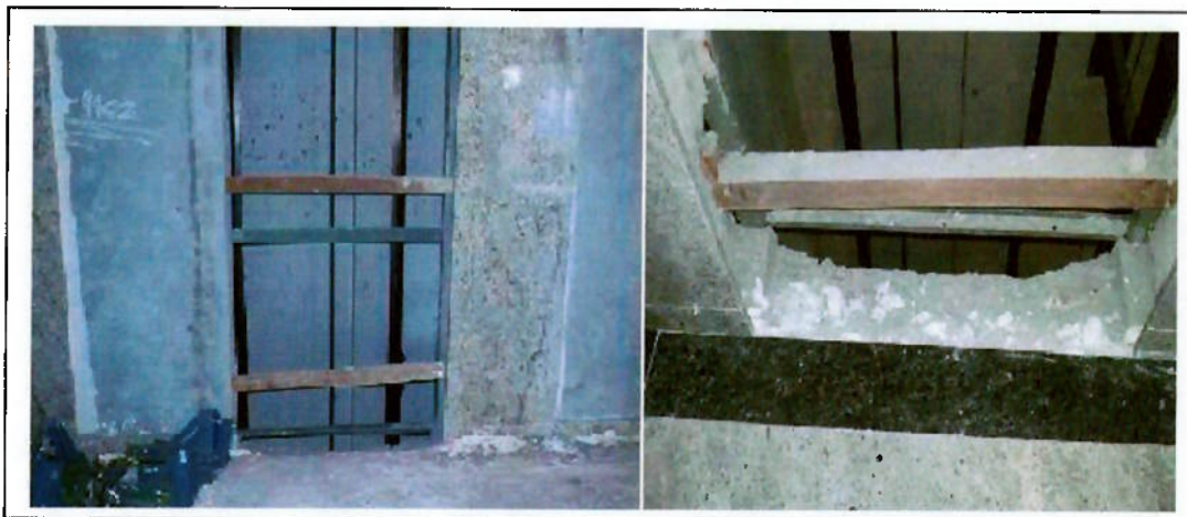
Figura 33: Falta da proteção de pavimento
